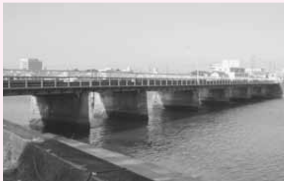
安全・安心のまちづくりに向けた橋梁整備を（昭和50年完成の津興橋／柳山津興）
