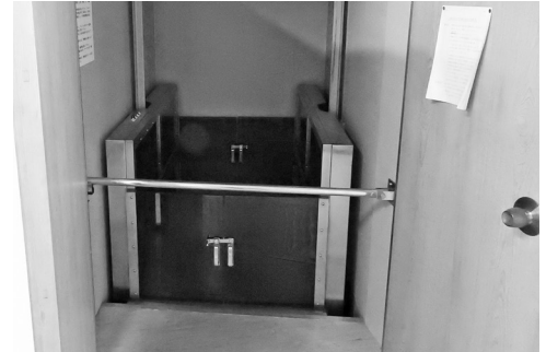
▲車いす用リフト
