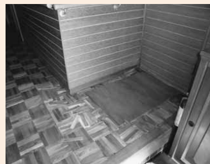
▲補償の遅れにより腐食が生じている民家（玄関）
