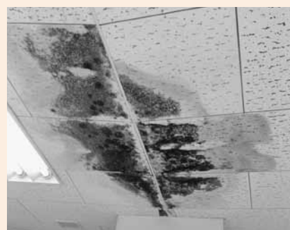
▲カビが生えたまま放置されている安濃球場の天井
